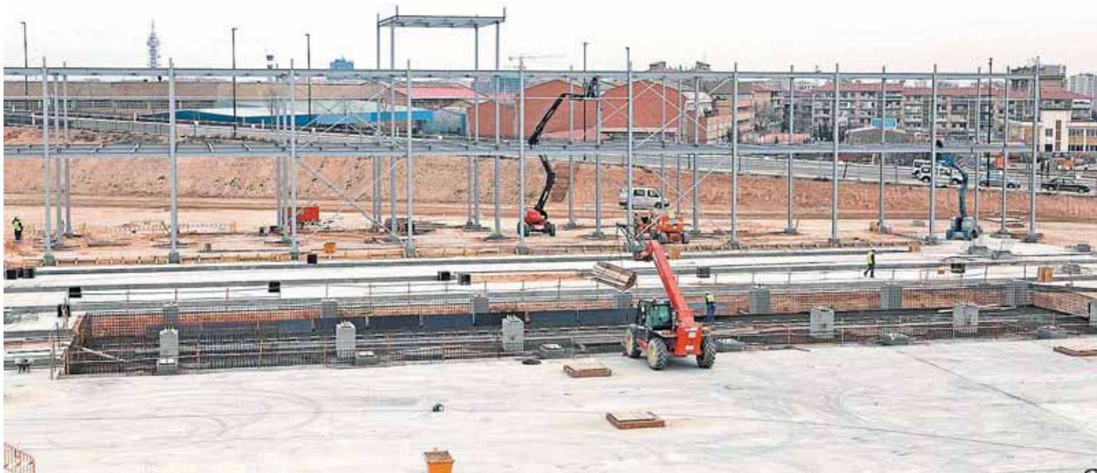
La estructura de hormigón que sustentará el edificio en el que se ubicarán las oficinas y el centro de control, ayer, vista desde la calle Volver a empezar de Valdespartera.
